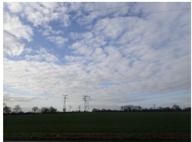
Photo 42 : Lignes Très Hautes et Hautes Tensions à Louisfert. Source : GAMA Environnement
