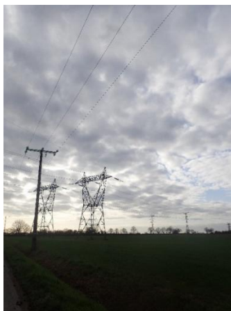
Photo 41 : Lignes Très Hautes et Hautes Tensions à Louisfert. Source : GAMA Environnement
